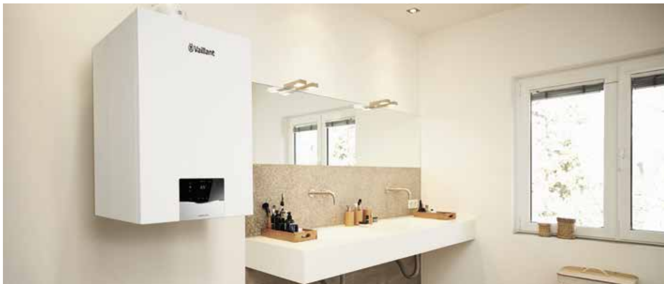
ecoTEC plus VCI: Gaspanna utanpå en 25 l varmvattentank
